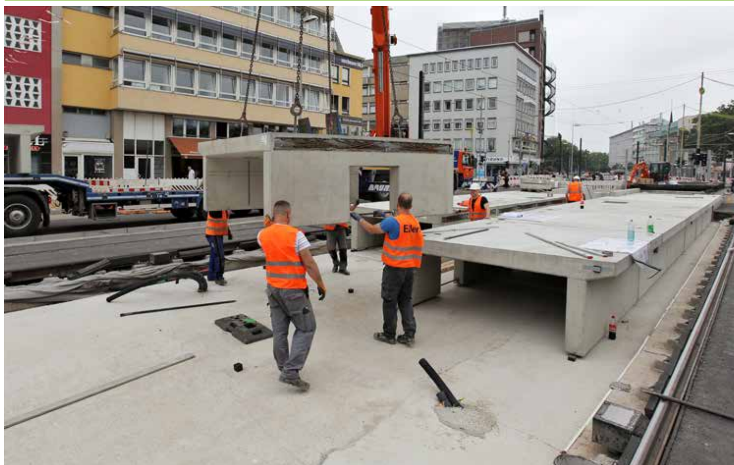
Mit einem Kran werden die schweren Fertigbauteile des Hochbahnsteiges vom Tieflader gehoben.
