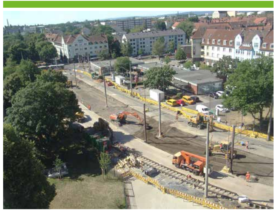
3. Juli 2018: Beide Schienenstränge sind entfernt. Bauzäune grenzen den Arbeitsbereich ab. Das gute Wetter sorgt für einen reibungslosen Ablauf.
