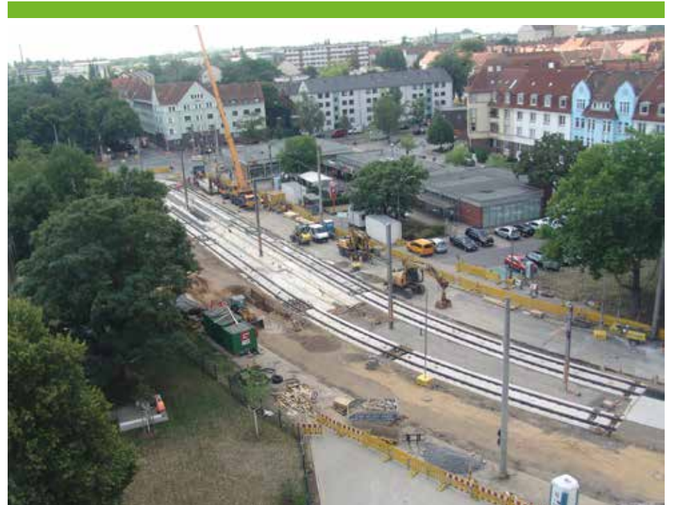
25. Juli 2018: Mit einem großen Kran werden Bauteile an ihren Platz gehievt. Der Untergrund wird befestigt, damit er den schweren Aufbau trägt.
