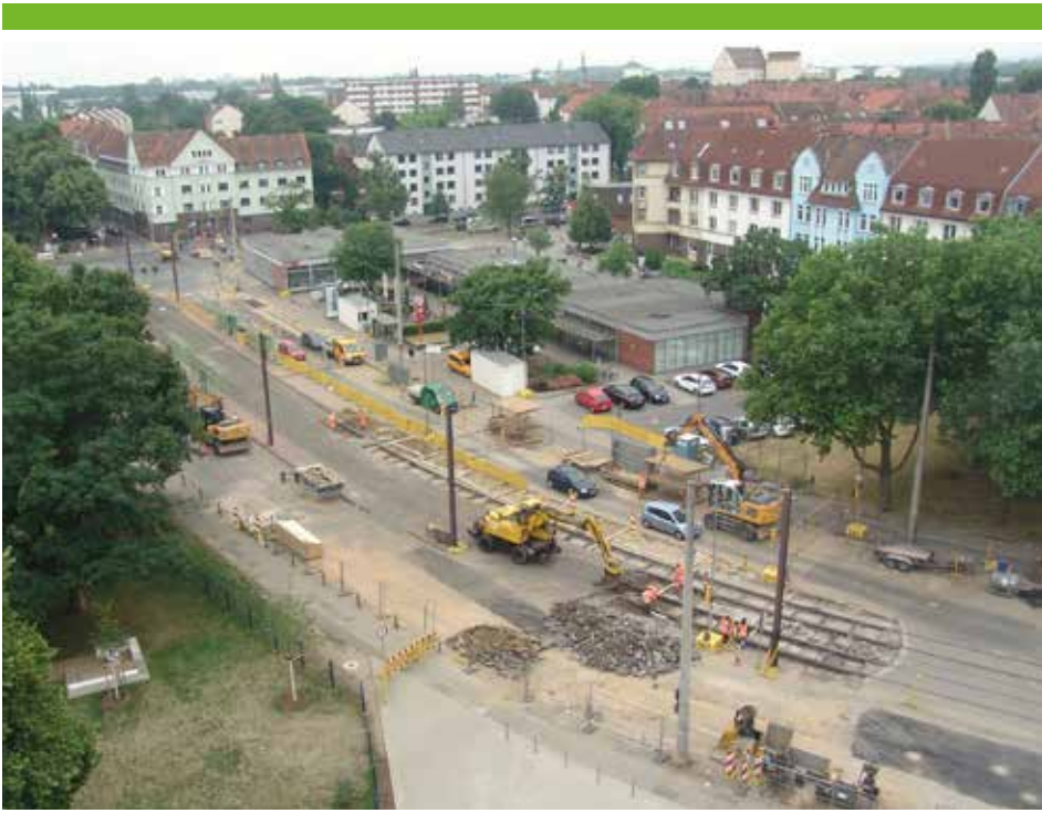
6. Juni 2018: Lange spielten sich die Arbeiten im Untergrund ab. Dann werden die alten Schienen entfernt. Man sieht, es passiert etwas.
