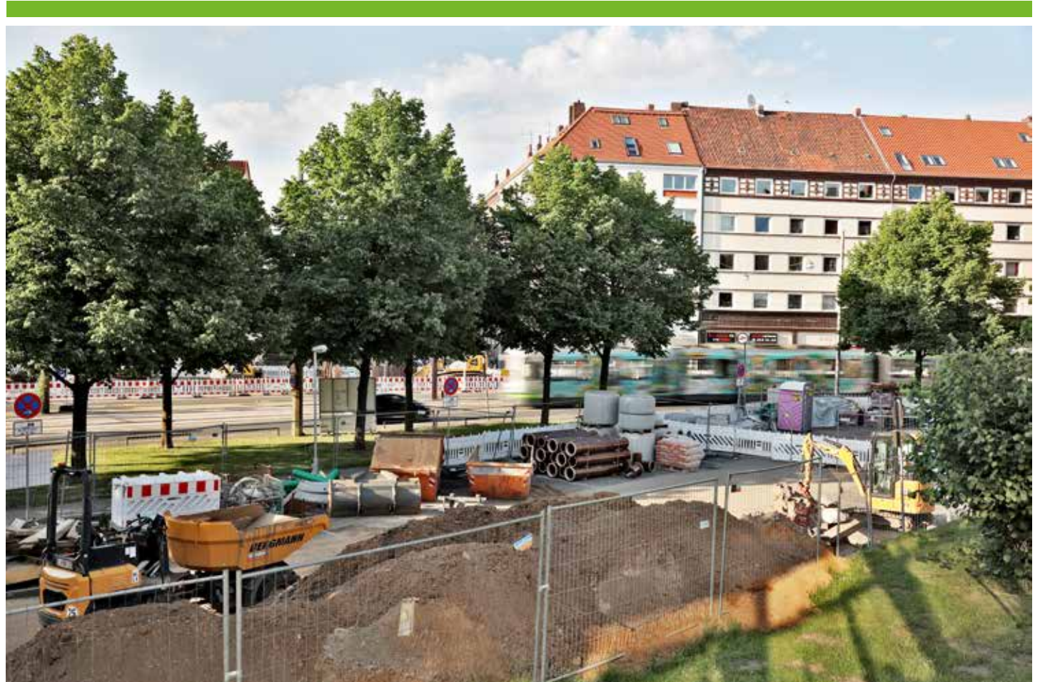
Das Baumaterial für die Leitungsarbeiten rund um den Hochbahnsteig wird neben der Straße gelagert
