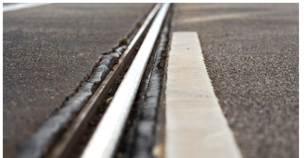
Nach mehreren Reparaturen ist eine Gleissanierung unausweichlich.
